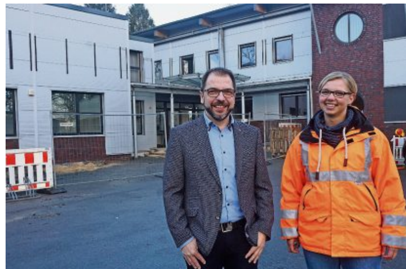
Matthäi-Geschäftsführer Jens Hinck und Bauleiterin Verena Meyer freuen sich bereits jetzt auf den Neubau. Im Hintergrund ist das aktuelle Bürogebäude zu sehen. Der weiß verkleidete Teil wird zurzeit entkernt, zeitnah abgerissen und durch einen weitaus größeren Neubau ersetzt. Foto: Bick
